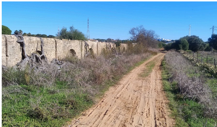
Estado de la plataforma, con arenas, en la calle Romería que presenta un viaducto antiguo
