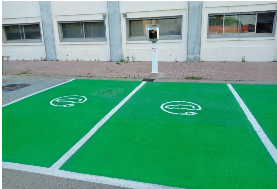
Figura 170. Puntos de recarga de vehículo eléctrico en el Campus de Puerto Real.
