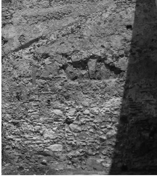
Figura 4. Arco adintelado cegado y la impronta de la cubierta a un agua, tal y como se encontró. Vista calle San José
